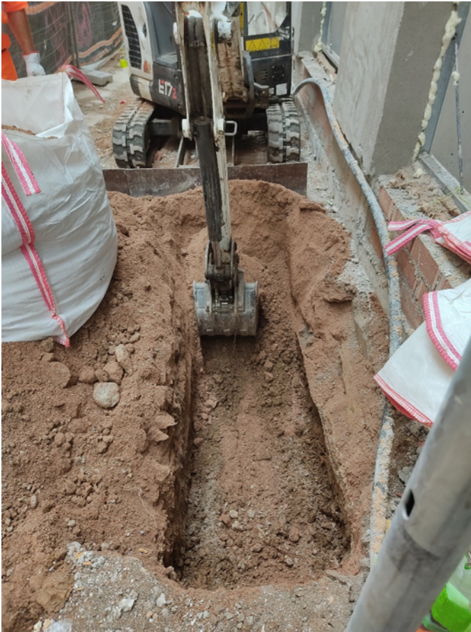
Foto 1: inici de la rasa al carrer de l'Arc del Teatre des de la placeta d'Anna Murià.
